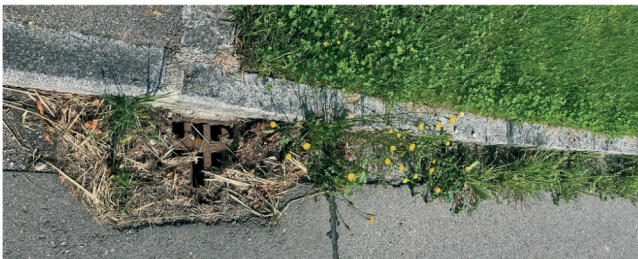
In dieser Rinne kann das Wasser nicht ablaufen.
